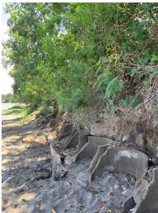
Gambar 6. Kondisi Pantai Tebing setelah terjadi abrasi
